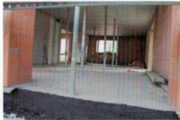
Blick ins Erdgeschoss – In diesem Bereich wird die Betreuung und Förderung von Menschen angeboten werden, die wegen schwerer Mehrfachbehinderung nicht in die Werkstätte gehen können
